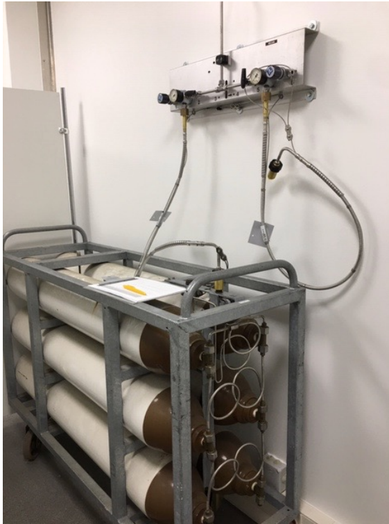
Rack de récupération de gaz haute pression. 6 bouteilles 9 m 3 . 200 bars.
